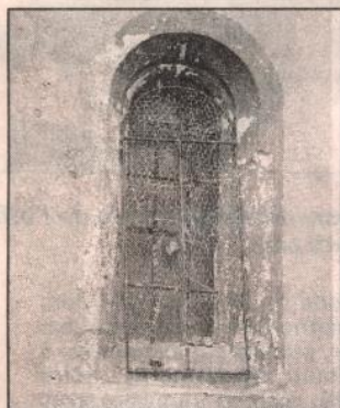
La fenêtre la plus accessible récemment saccagée.
